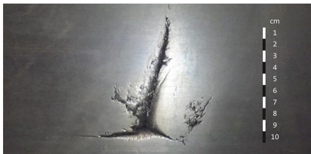
Protubérance apparente (doit être réparée ou remplacée)
