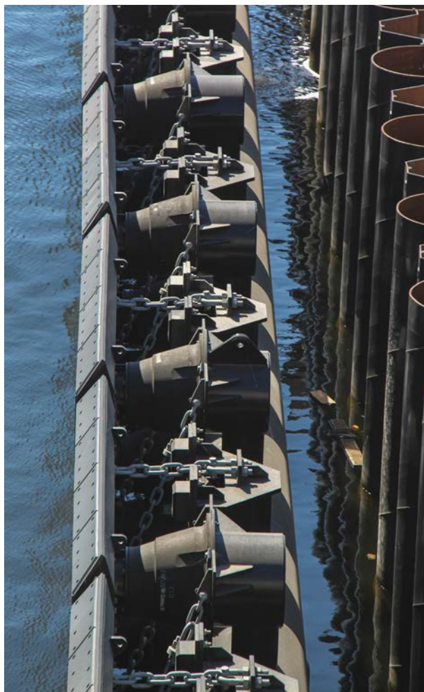
Odbojnice stożkowe (SPC) | IJmuiden | Holandia
